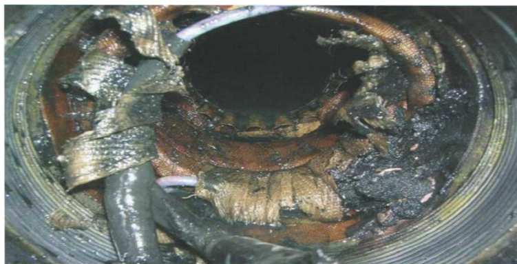
Рис. А.15.1. Прогар выводных концов обмотки статора (негерметичность системы «кабель - ПЭД-ГЗ»)
