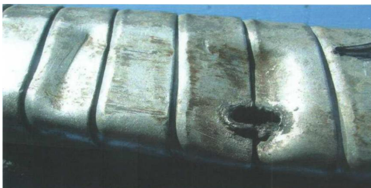
Рис. А.12. Электропробой кабеля в месте механического повреждения.
