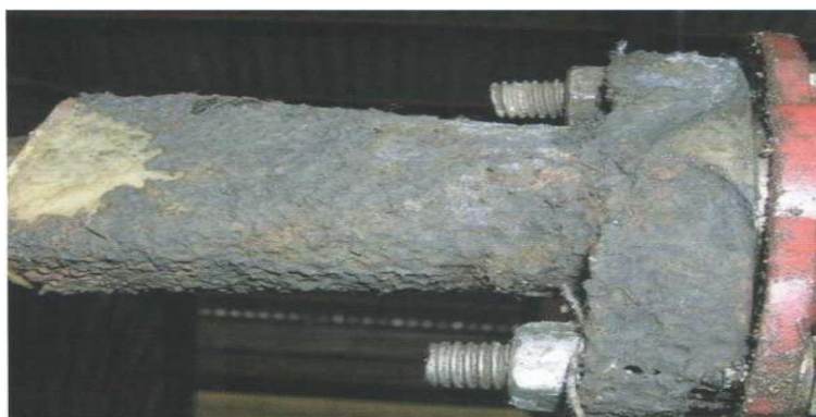
Рис. А.14. Коррозия корпуса кабельной муфты.
