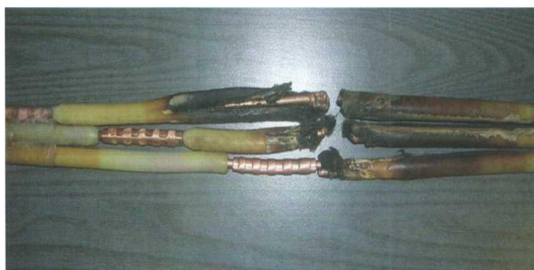
Рис. А.10. Погружной кабель. Прогар в ссостке.
