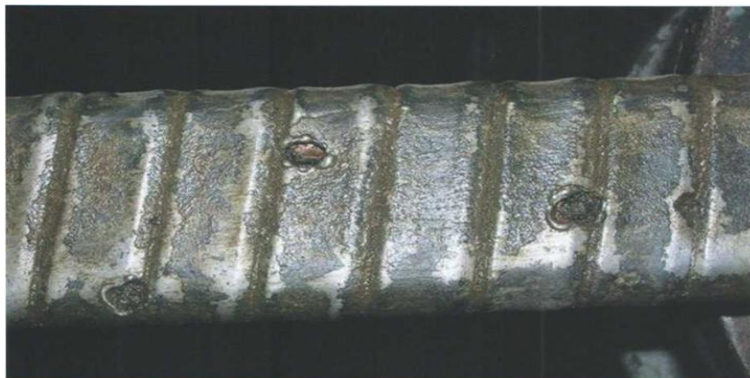
Рис. А.11. Электропробой кабеля на ровном месте.
