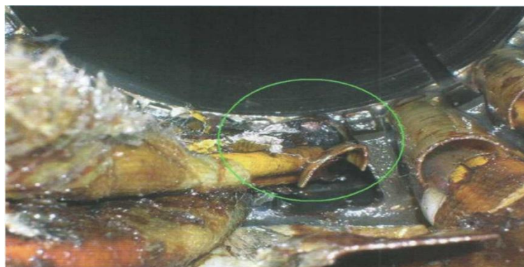
Рис. А.15.2. Электропробой обмотки статора (негерметичность системы «кабель - ПЭД-ГЗ»).
